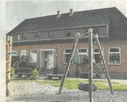
In Grönwohld sickert Wasser durchs Dach des Schulgebäudes
